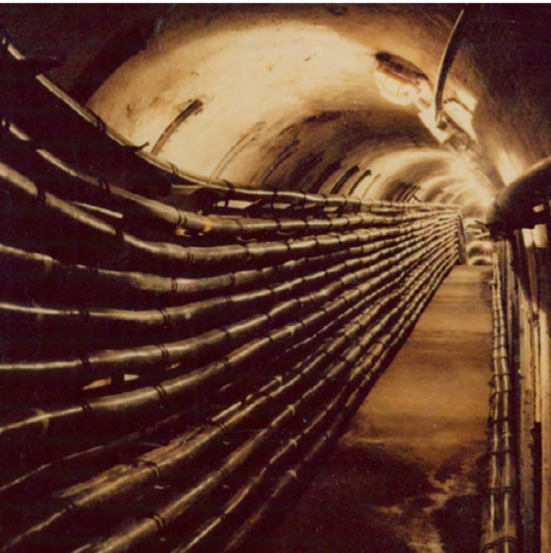
Galería de cables de acceso a una central telefónica.
