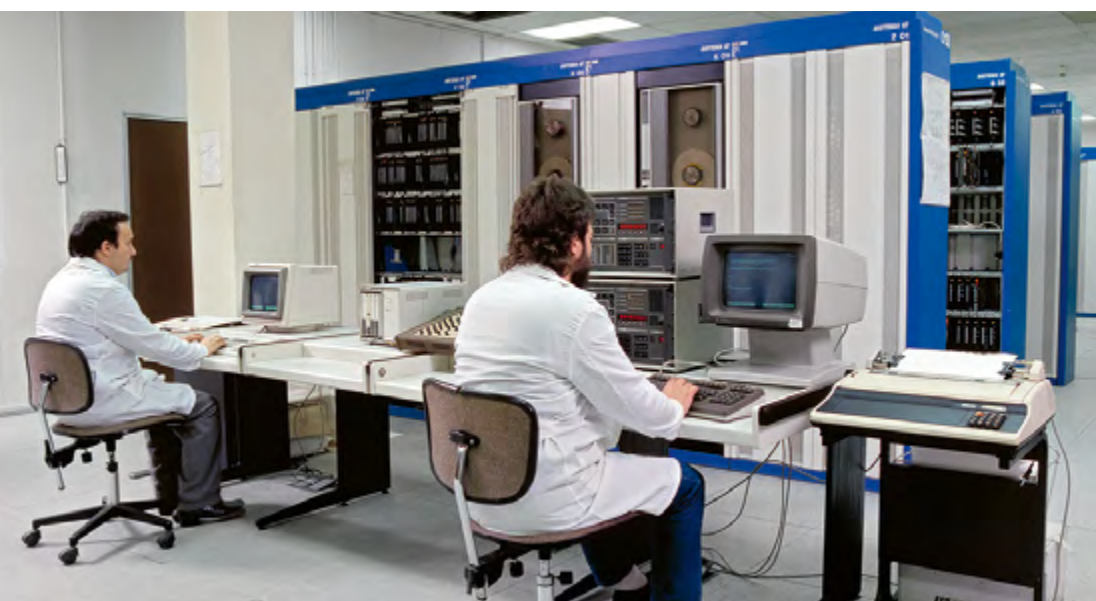
Consola central 1240 instalada en la central Diana de Madrid.
