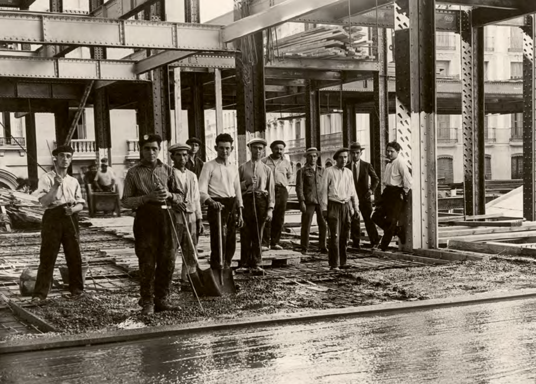
Hormigonado de una planta del edificio de Gran Vía, 30 de julio de 1927.
